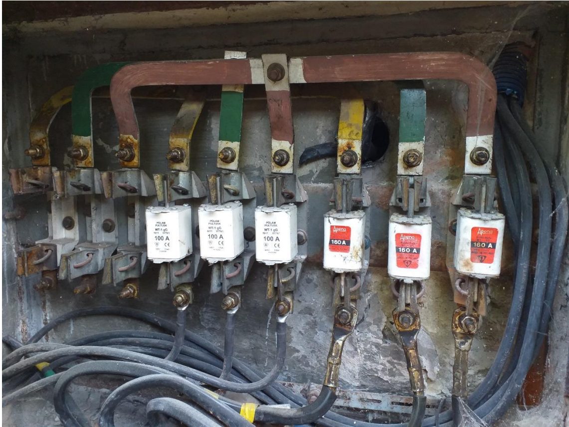
Foto. istn. złącze kablowe ZK-3 na zewn. w elewacji
